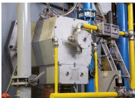
REGFIRE®-Brenner an einem Drehherdofen zum Schmieden von Ringen REGFIRE®-burner on a rotary hearth furnace for forging of rings
